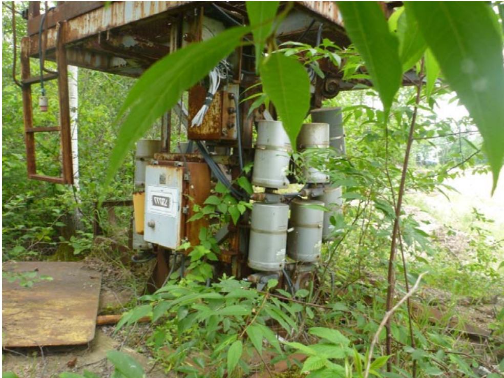
Photo 26, point 6 : équipement hydro-électrique et transformateur pouvant possiblement contenir des BPC abandonnés sur le site (8 au 19 juillet 2013)
