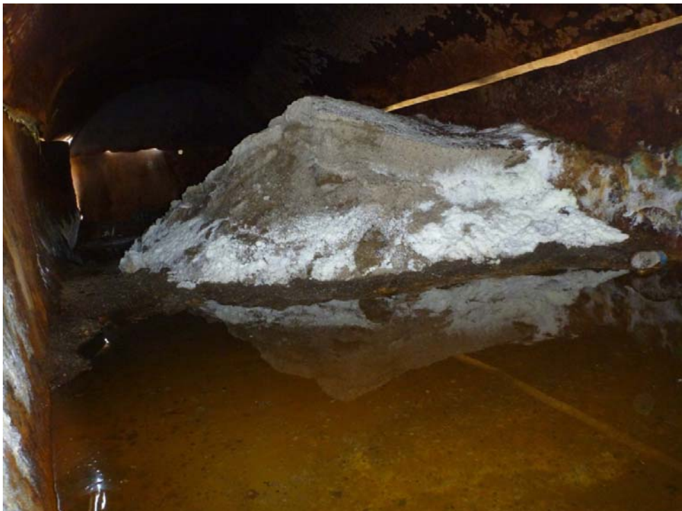
Photo 8, point 17 : produits à l'intérieur du réservoir identifié sur la photo 7, possiblement des sels de voirie (8 au 19 juillet 2013)
