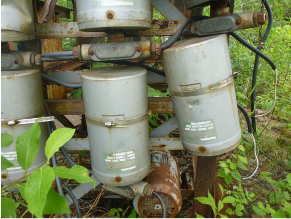
Photo 27, point 6 : vue rapprochée des transformateurs pouvant possiblement contenir des BPC (8 au 19 juillet 2013)
