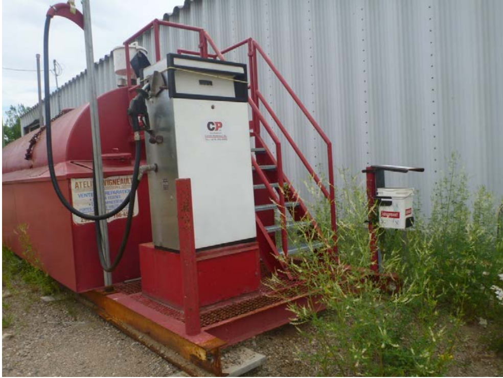
Photo 29, point 6 : réservoir et pompe sans tablier de béton, reposant directement sur le sol graveleux. Aucune tache ou odeur n'ont cependant été notée à cet endroit (8 au 19 juillet 2013)
