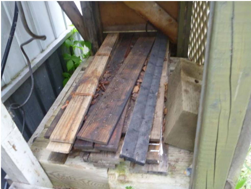
Photo 16, point 12 : réservoir de mazout (sous le réservoir, planches tachées d'huile). Aucune tache au sol, odeurs fortes de mazout (8 au 19 juillet 2013)
