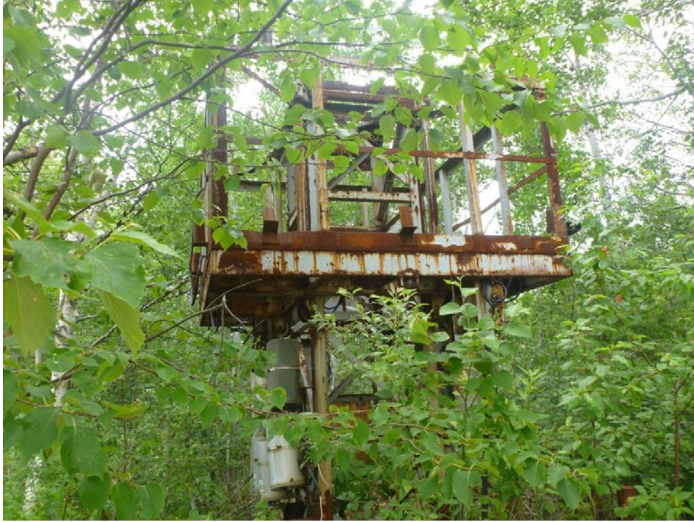
Photo 25, point 6 : équipement hydro-électrique (possiblement une ancienne tour) abandonné sur le site (8 au 19 juillet 2013)
